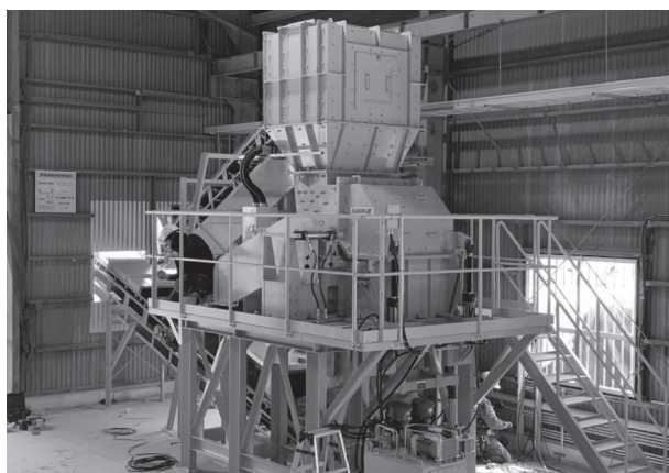
MHM（ハンマーミル）の納入事例
