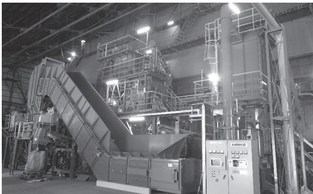
セメント工場内に計画した廃プラ破碎選別設備導入事例
