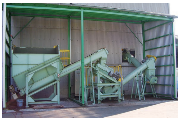
生ゴミ堆肥化設備 (生ゴミの定量供給に利用)
