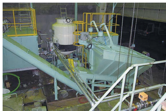
RDF製造設備 (下水汚泥の定量供給に利用)
