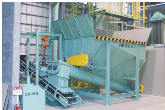
木質ペレット製造設備 (木質チップの定量供給に利用)
